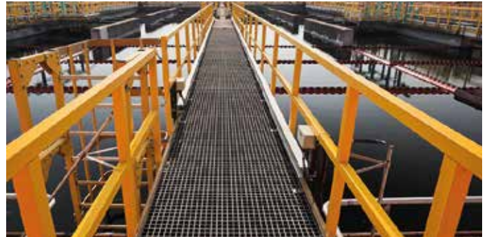
Depuración de agua
